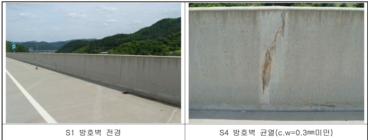
【사진 3.12】 방호벽 손상 현황
