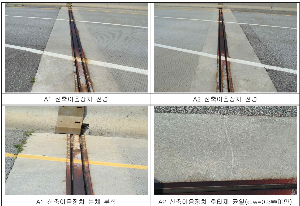
【사진 3.8】 신축이음장치 손상 현황
